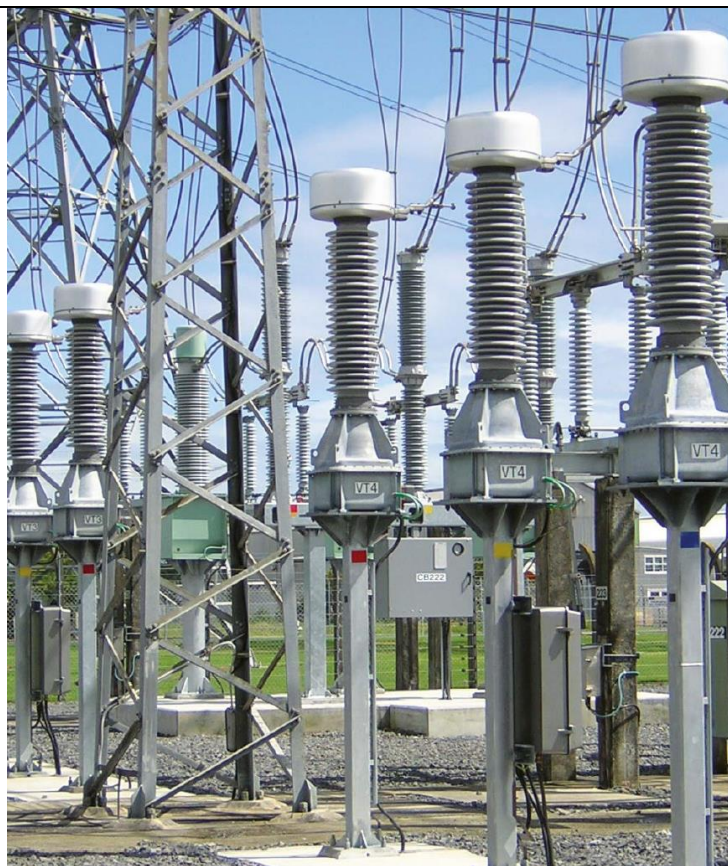
Obrázek 29: Příklad instalace měřicích transformátorů napětí firmy Artech
